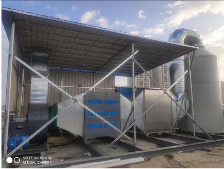
废气处理设施
