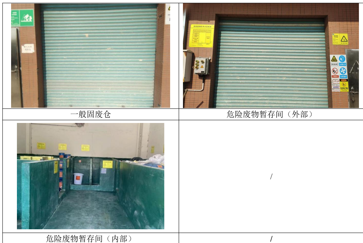
图 4-5 固体废物暂存场所
