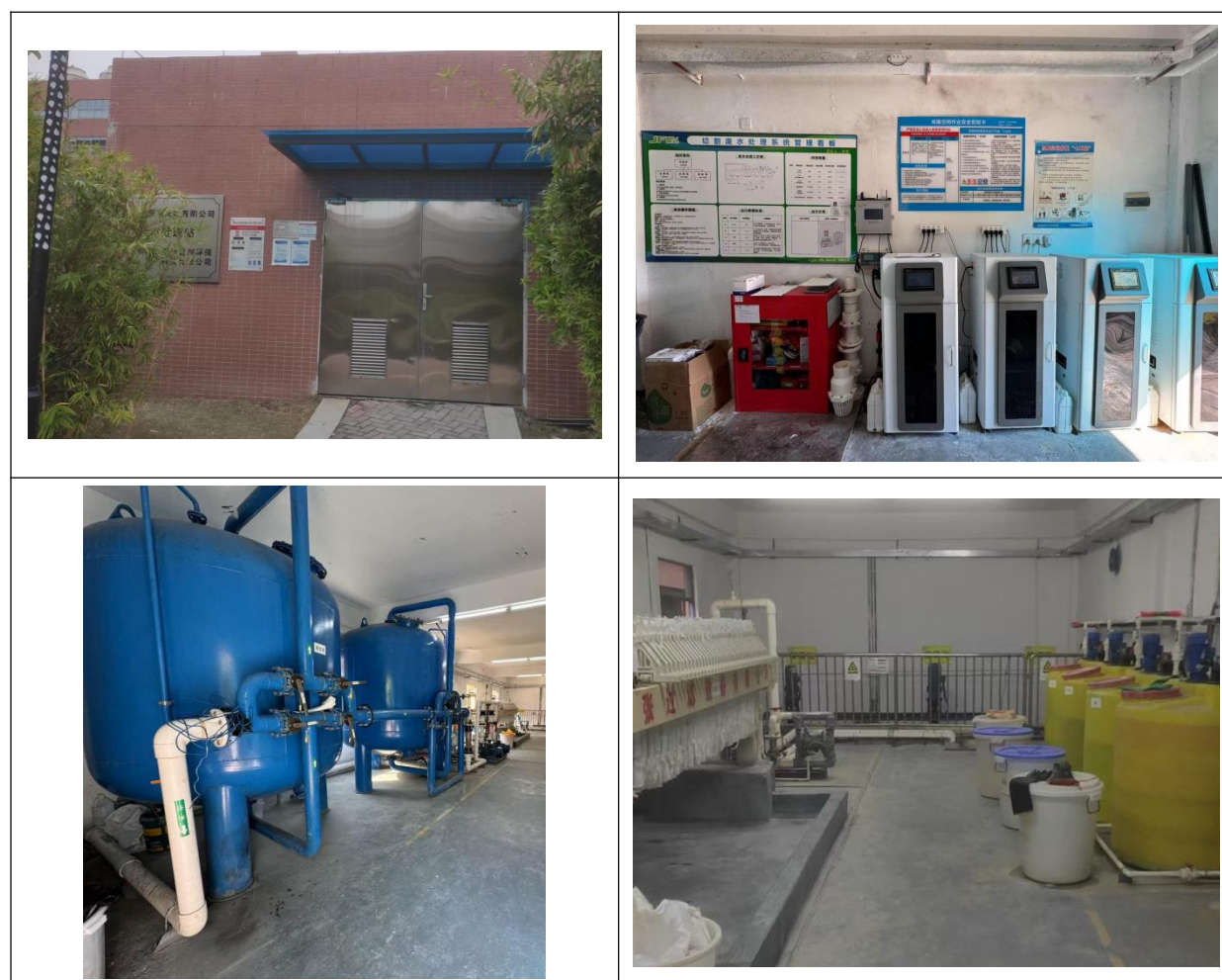
图4-2 项目废水处理站
