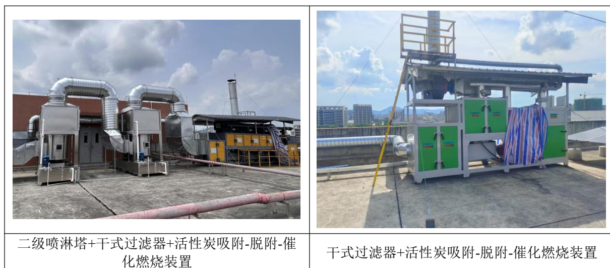
图 4-2 废气治理设施
