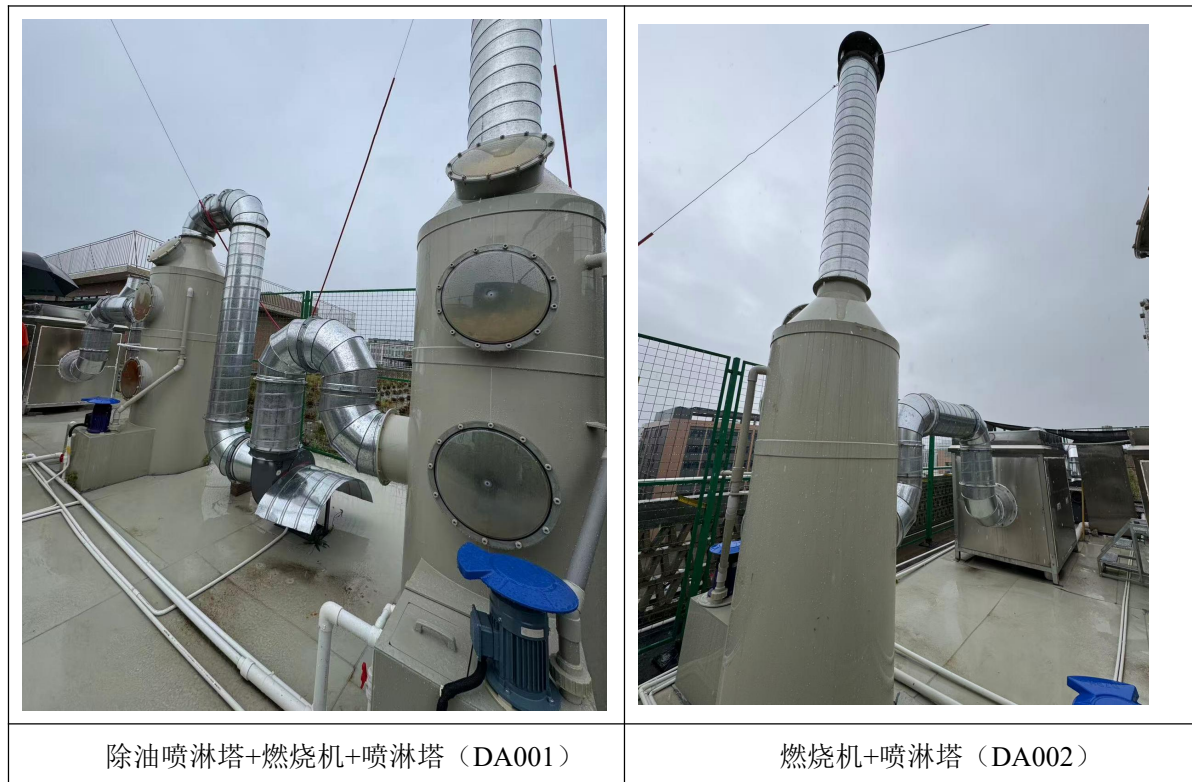
图 4-2 废气治理设施
