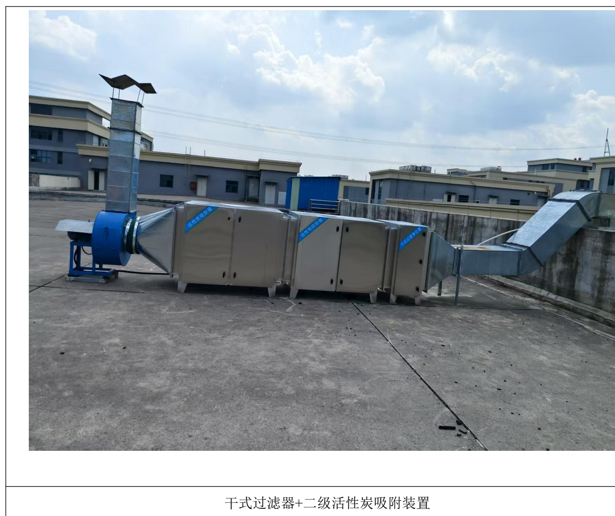
图 4-2 废气治理设施
