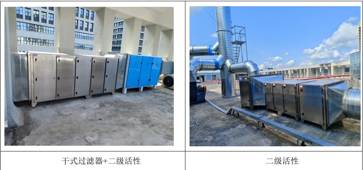
图 4-2 废气治理设施
