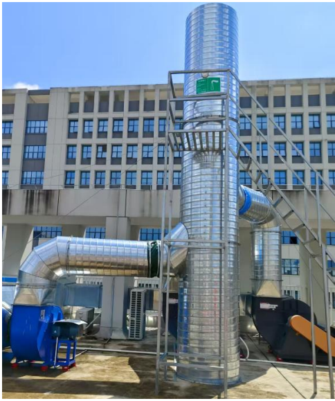
DA001 废气采样口
