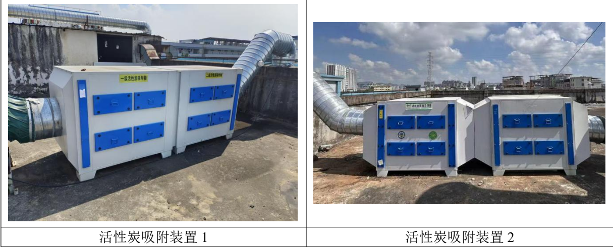
图 4-2 废气治理设施
