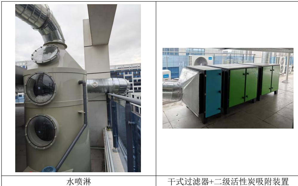
图 4-2 废气治理设施
