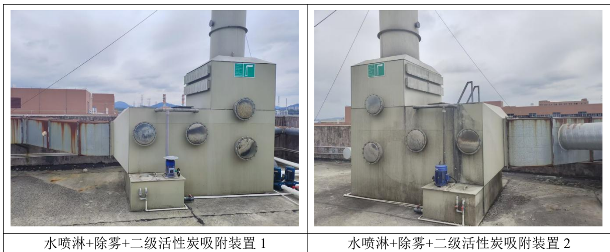
图 4-2 废气治理设施
