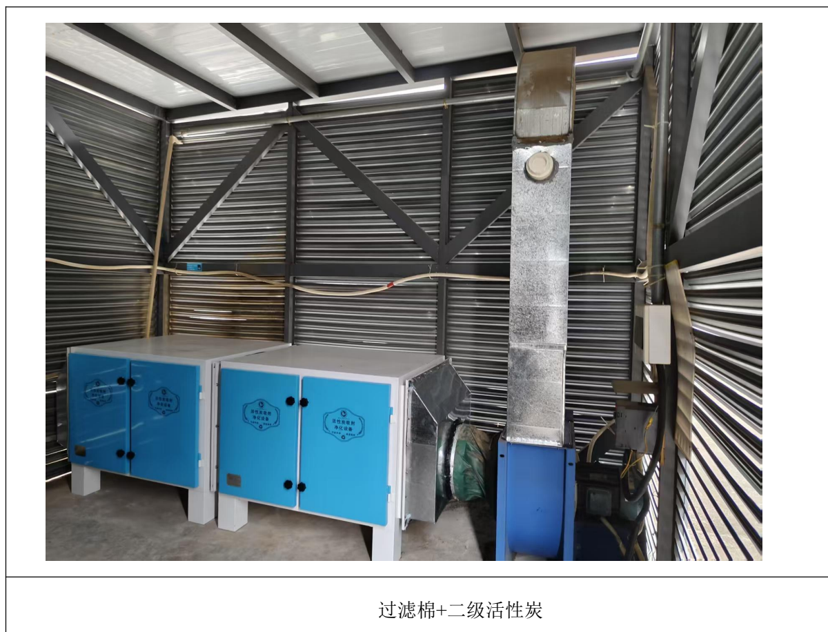
图 4-2 废气治理设施
