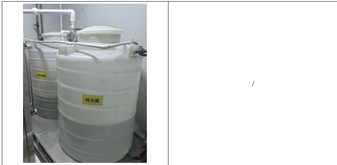
图 4-2 废水治理设施
