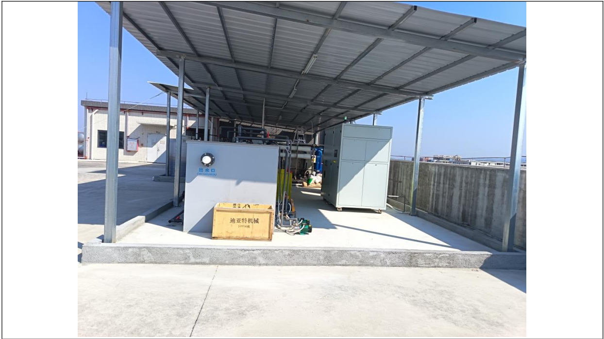
图 4-2 项目废水治理设施图
