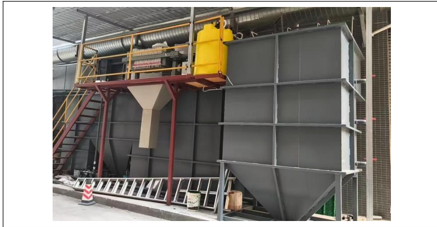
图 4-2 废水治理设施
