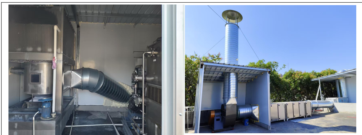
水喷淋+干式过滤+两级活性炭吸附
