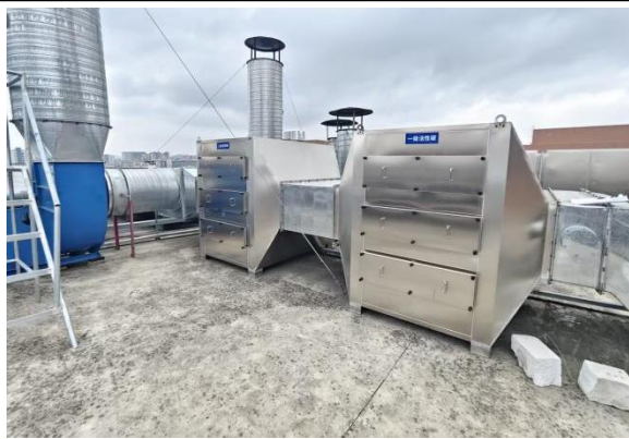
干式过滤+两级活性炭吸附装置 (A02 厂房 3#)
