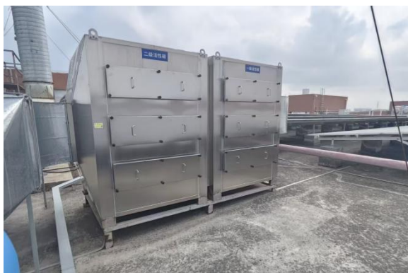
干式过滤+两级活性炭吸附装置 (A01 厂房 6#)
