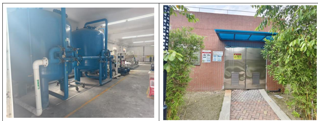
图 4-2 废水治理设施
