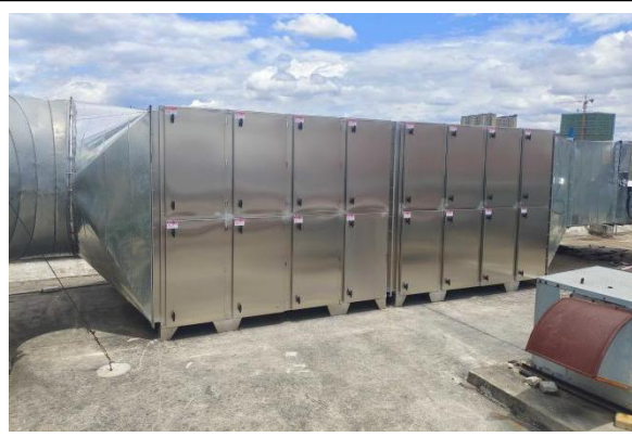
干式过滤+两级活性炭吸附装置 (A02 厂房 4#)
