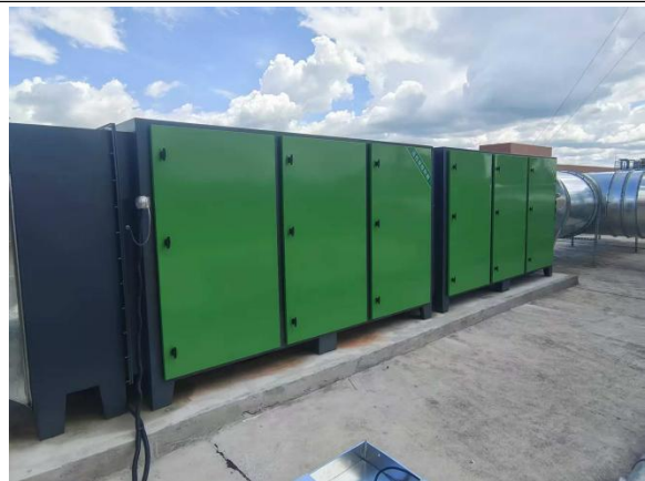
干式过滤+两级活性炭吸附装置 (A03 厂房 9#)
