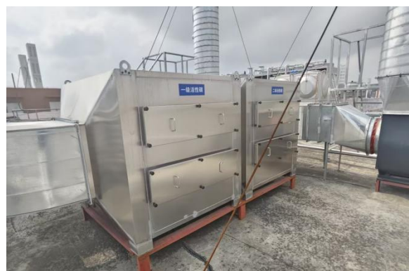
干式过滤+两级活性炭吸附装置 (A01 厂房 7#)
