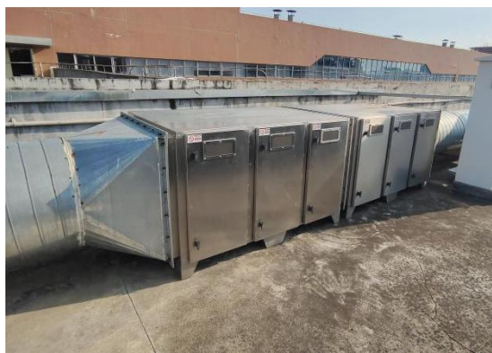
干式过滤+两级活性炭吸附装置 (动力厂房 5#)
