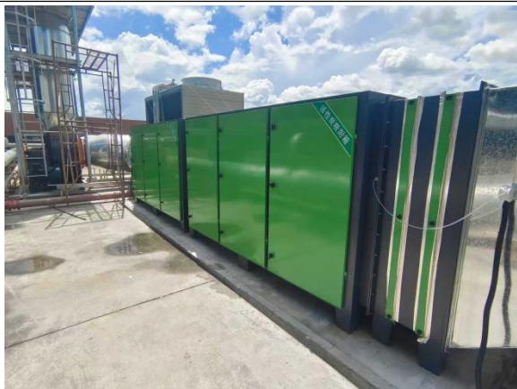
干式过滤+两级活性炭吸附装置 (A03 厂房 8#)
