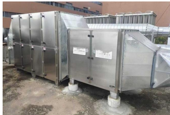
两级活性炭吸附装置 (废料仓)
