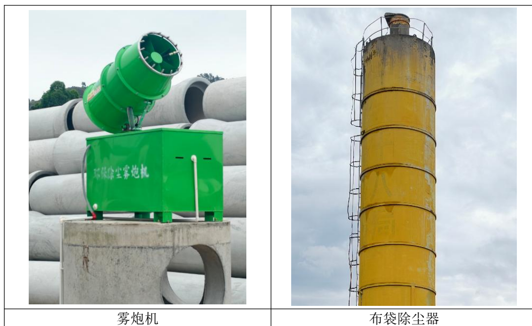
图 4-1 废气治理设施
