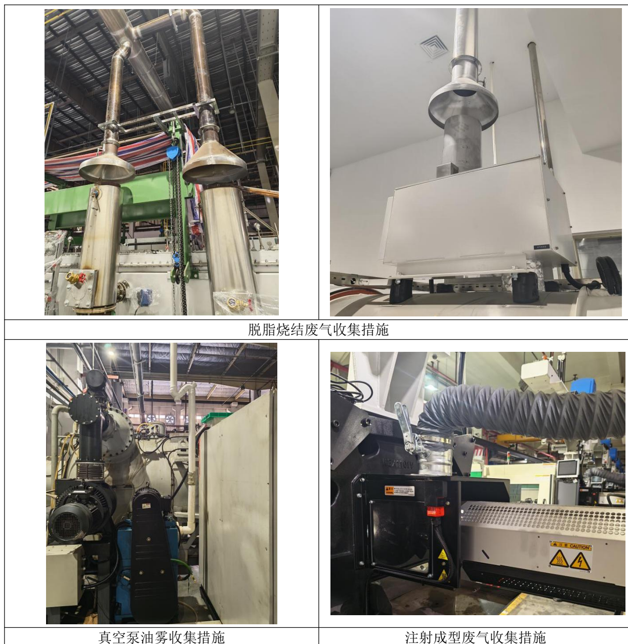
图 4-2 废气治理设施及废气收集措施
