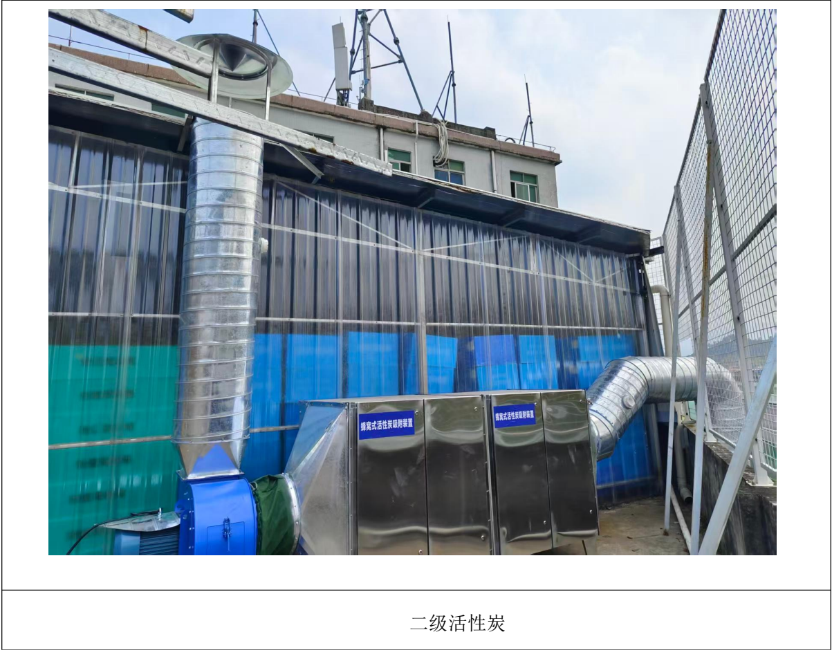
图 4-2 废气治理设施
